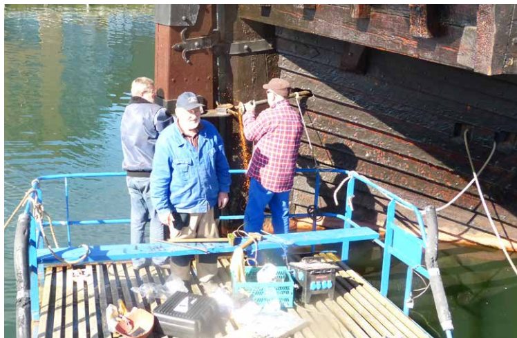
Arbeiten an der Ruderanlage
